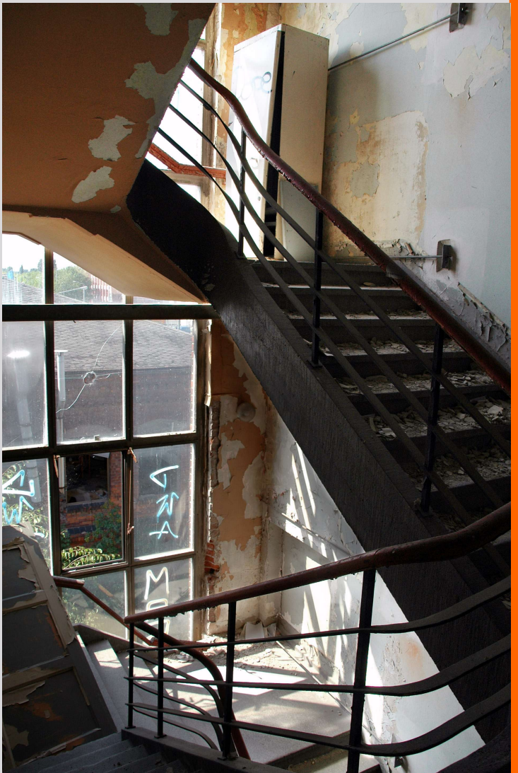
Treppenhaus, heute in sanierungsbedürftigem Zustand Stairwell, today in need of restoration
